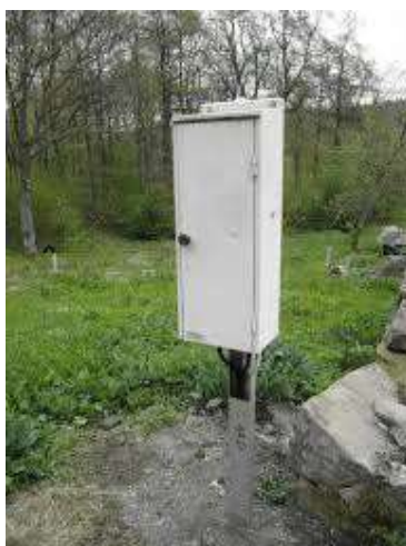
Glöm inte anslutningspunkt för el vid anläggande av konstgräsplaner
